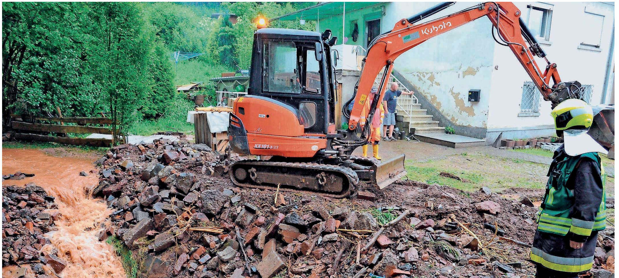
Aufräumarbeiten in vollem Gang: Mit Baggern wird in Dirmingen den Schlamm- und Geröllmassen zu Leibe gerückt. FOTOS: BECKER&BREDEL
