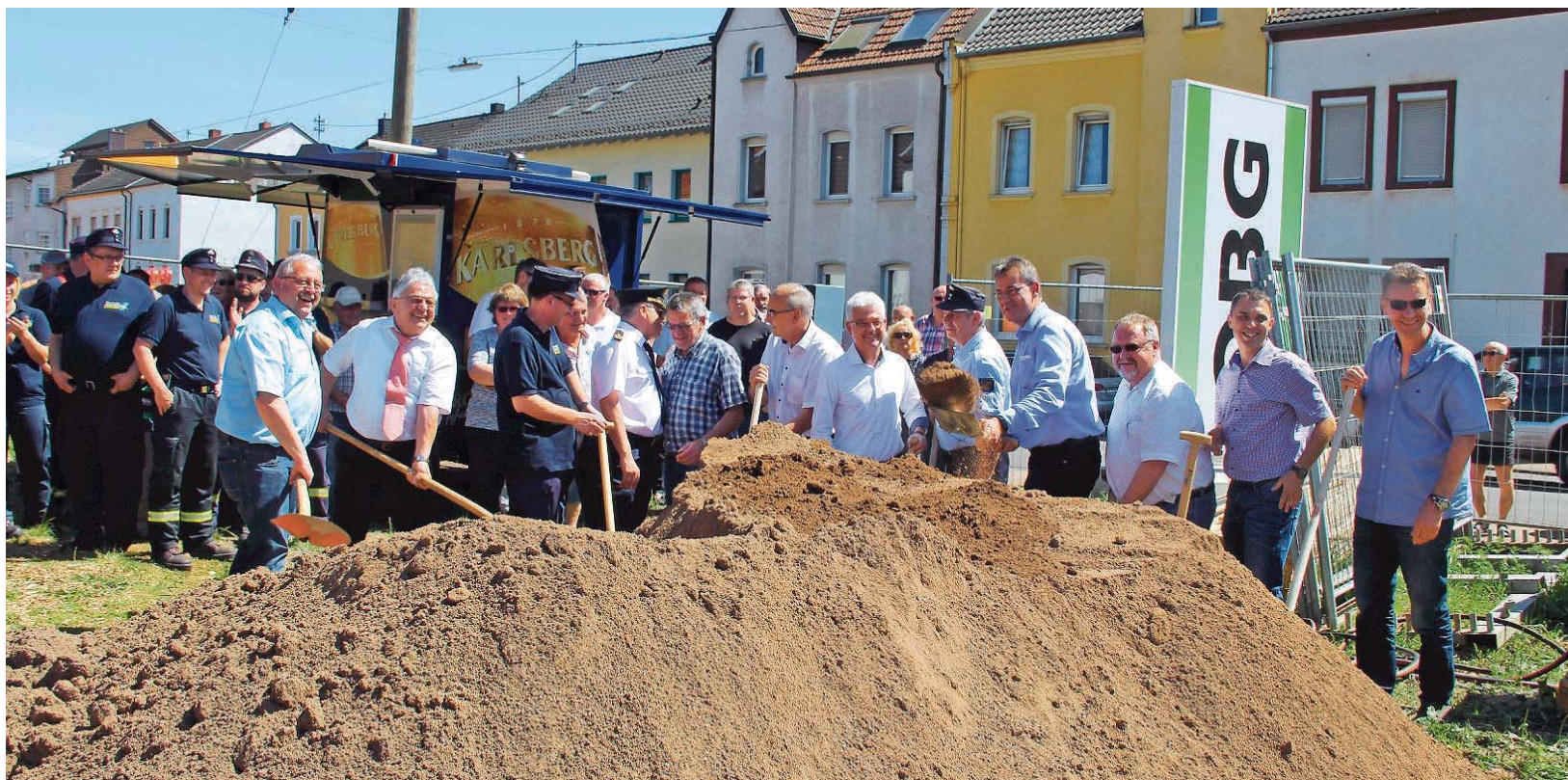
Wenn so viele mit anpacken, steht dem neuen Feuerwehrgerätehaus in Saarwellingen nichts mehr im Wege.
