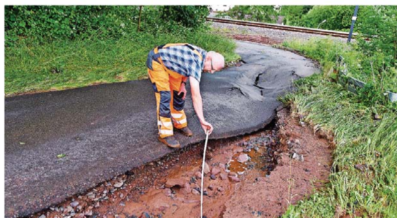
Die Gemeinde Heusweiler hat es besonders hart getroffen: An der Saarbahn-Haltestelle in Eiweiler misst ein Helfer die Tiefe eines Grabens.
