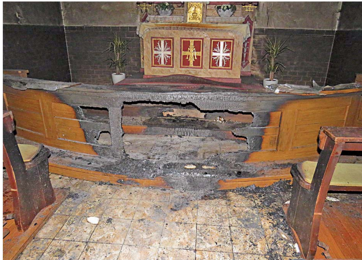
Der Innenraum der Kapelle auf Hächsten wurde Opfer eines Brandes, den ein Spaziergänger am Freitagmorgen entdeckte. 30 Feuerwehrleute waren zur Brandbekämpfung im Einsatz.
