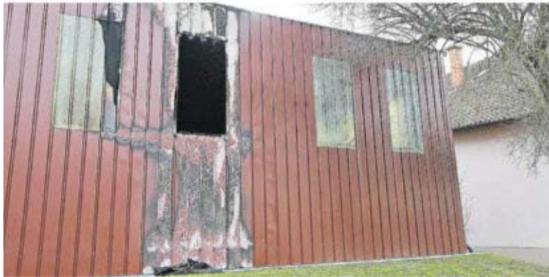
Ein Feuer hat am frühen Donnerstagmorgen eine Werkshalle in Hemmersdorf schwer beschädigt.
